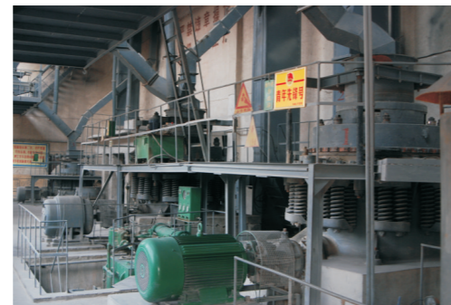
自动上料车间 Automatic feeding workshop
